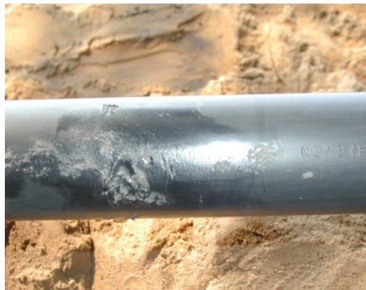
Abb. 1: Kabel-Mantelschaden als Folge von Ausgleichsvorgängen im 110-kV-Netz
